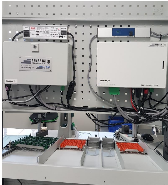
Bild 6: Anordnung der Klemmbox mit SWA Client und Netzteil an der Rückseite eines Arbeitsplatzes.
