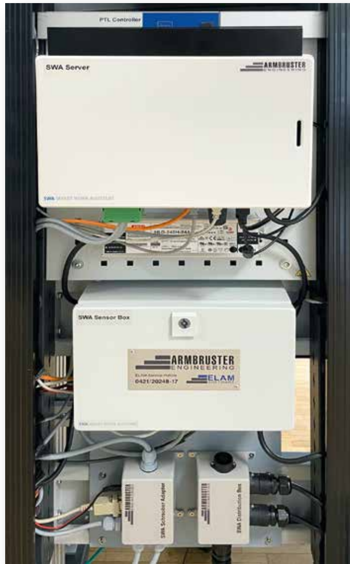
Anordnung der Klemmbox mit SWA und Netzteil an der Rückseite eines Arbeitsplatzes
